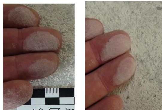
Fliesenablösung auf nicht belegreifem Calciumsulfatestrich. Sowohl auf der Fliesenunterseite (links) als auch auf der Estrichoberfläche (rechts) findet sich ein puderiger Belag
