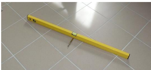
Riss in Raummitte mit V-förmiger Absenkung des Estrichs
